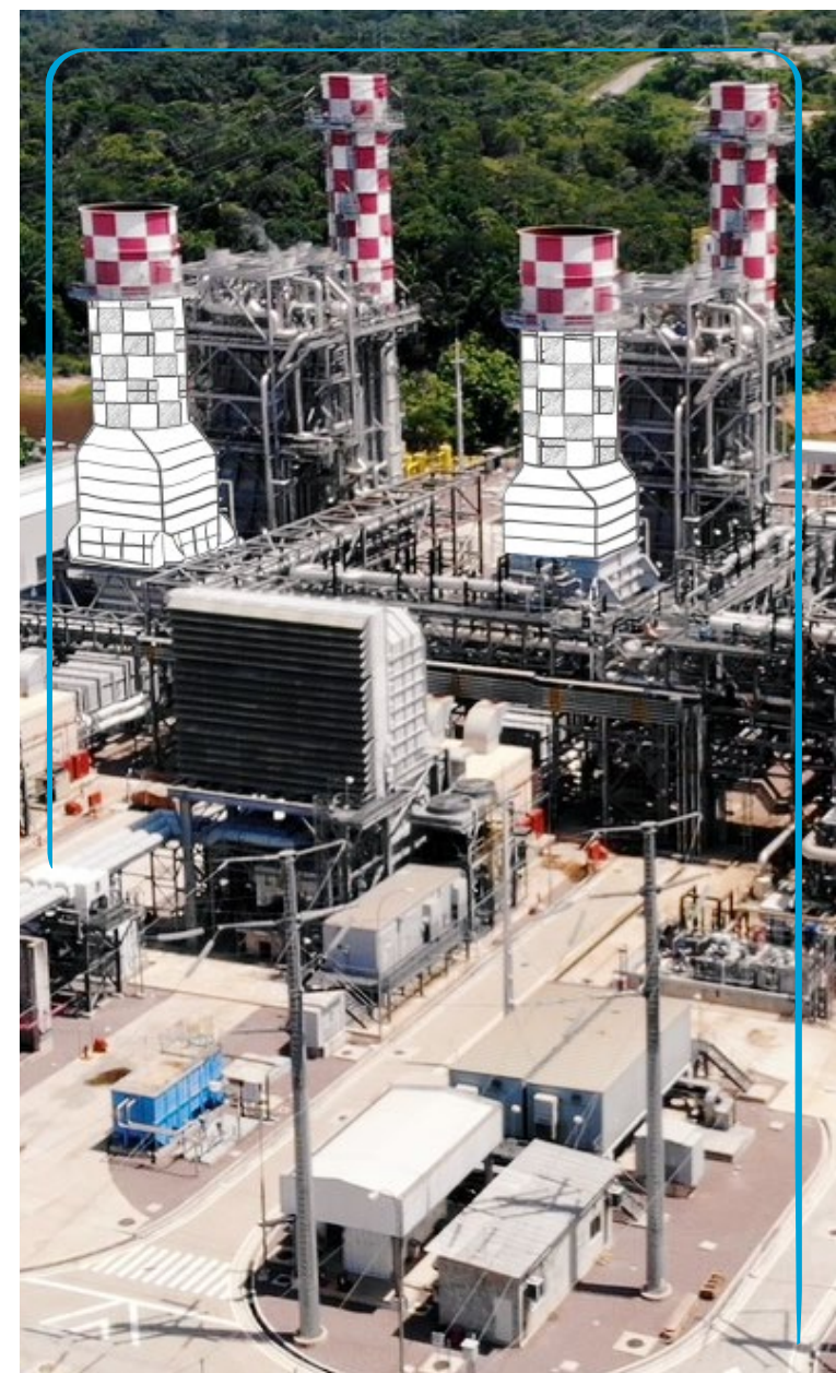
Usina termelétrica Mauá 3. Acervo Eletrobras Amazonas GT.
