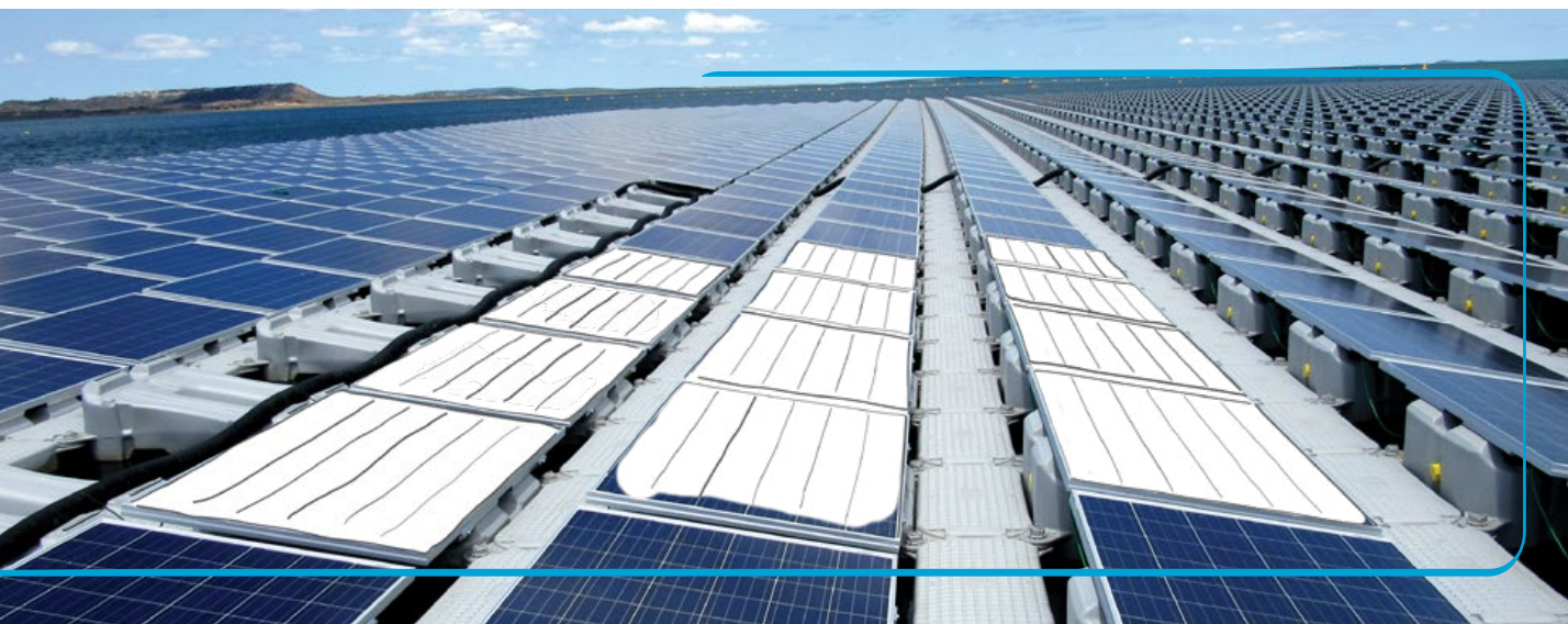
Placas solares flutuantes no reservatório de Sobradinho (BA). Acervo Chesf.
